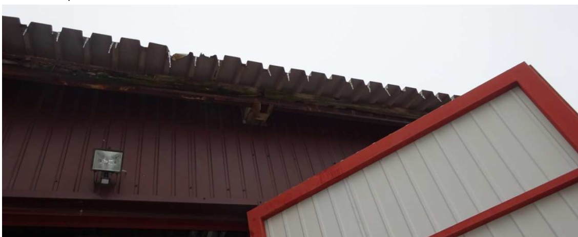
Płatew okapowa skorodowana
