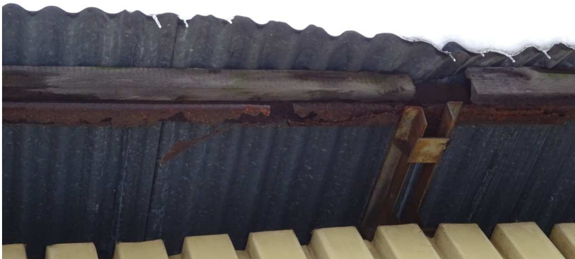
Skorodowana płatew okapowa, zdeformowane blachy pokrycia.
