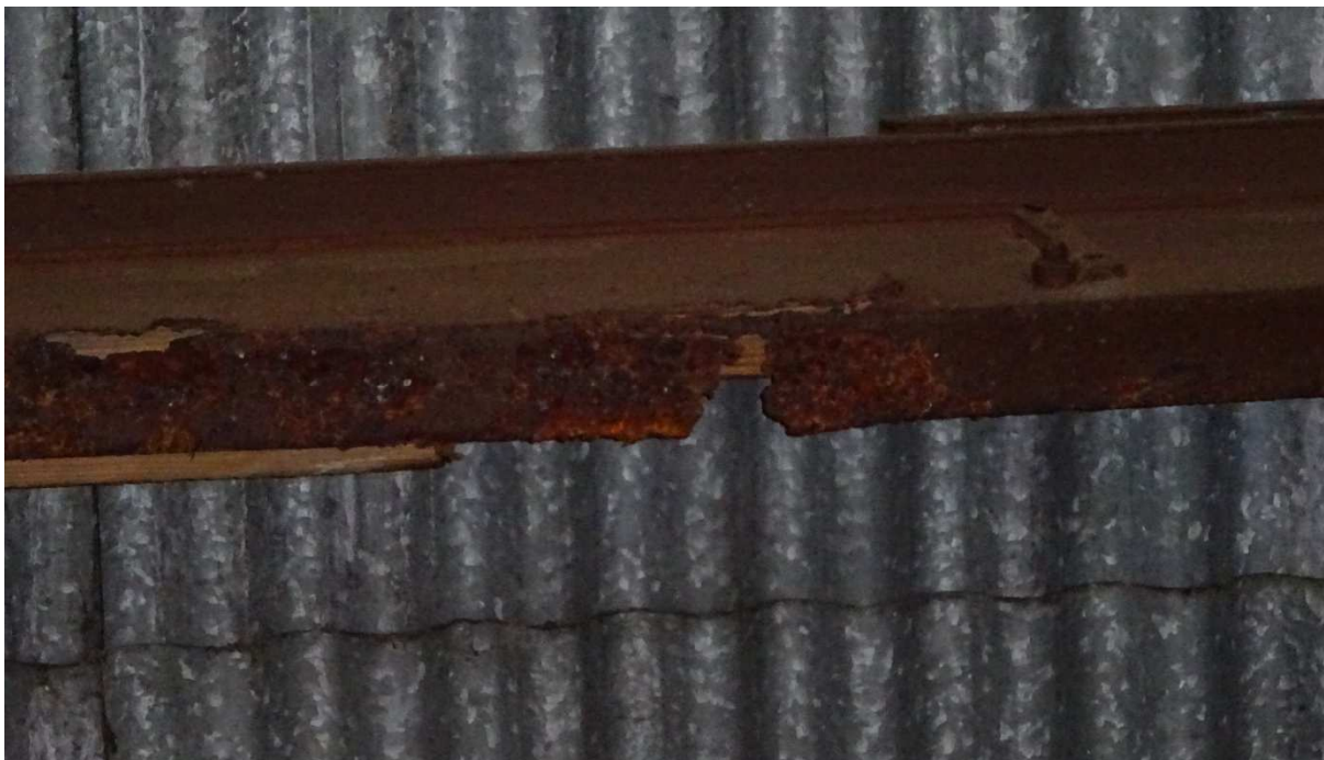
Całkowicie skorodowana płatew dachowa, blacha pokrycia łączona poza płatwią.
