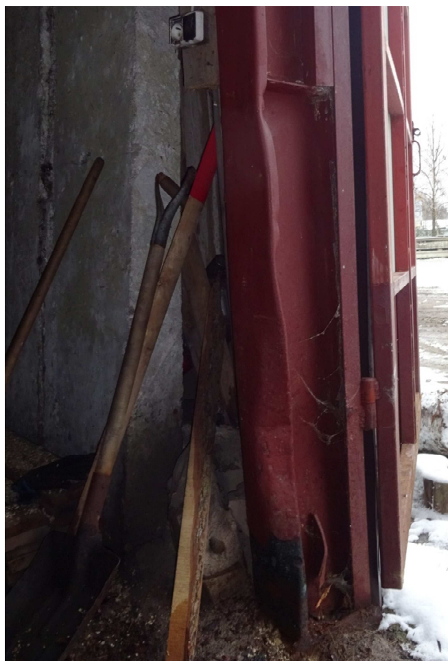
Uszkodzony słup hali, do – wyprostowania.
