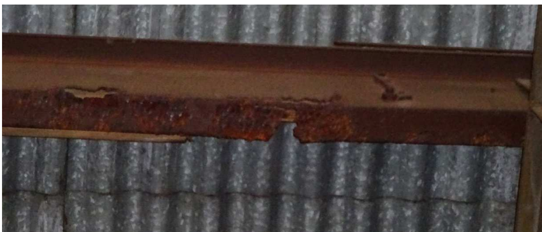
Skorodowana platew, łączenia blach poza płatwią.
