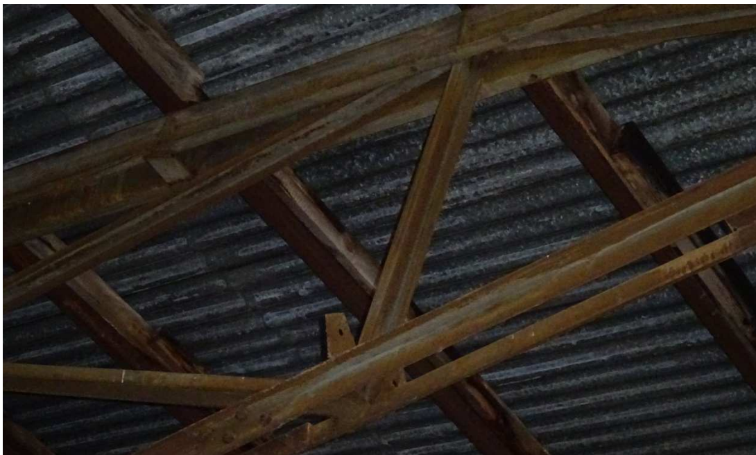
Skorodowane płatwie, widoczne elementy dźwigara do mocowania stężeń pionowych dachu.
