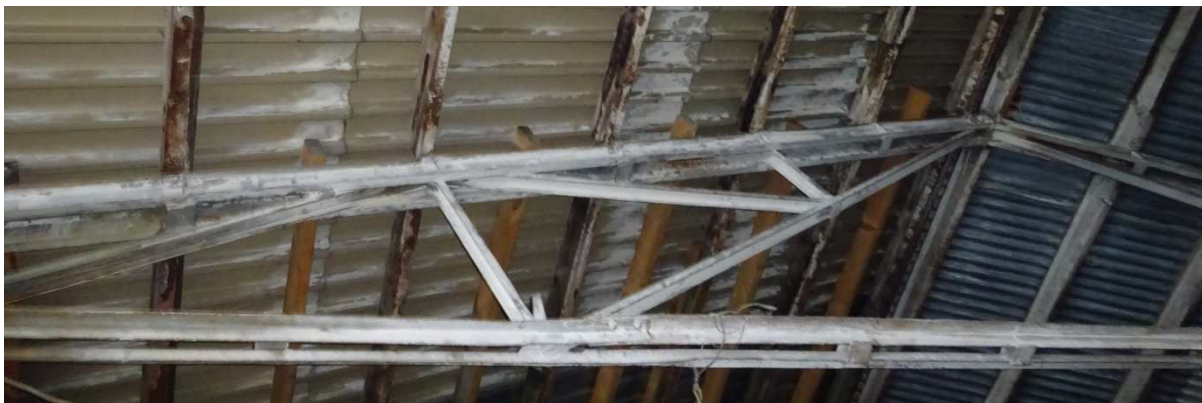
Widok skorodowanych płatwi i dźwigara hali, blachy pokrycia trapezowe i fałdowe o różnej długości, połączenia blach poza płatwiami
